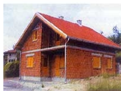
Faze obnove jedne kuće u Kusionjama od rušenja oštećene do izgradnje nove
