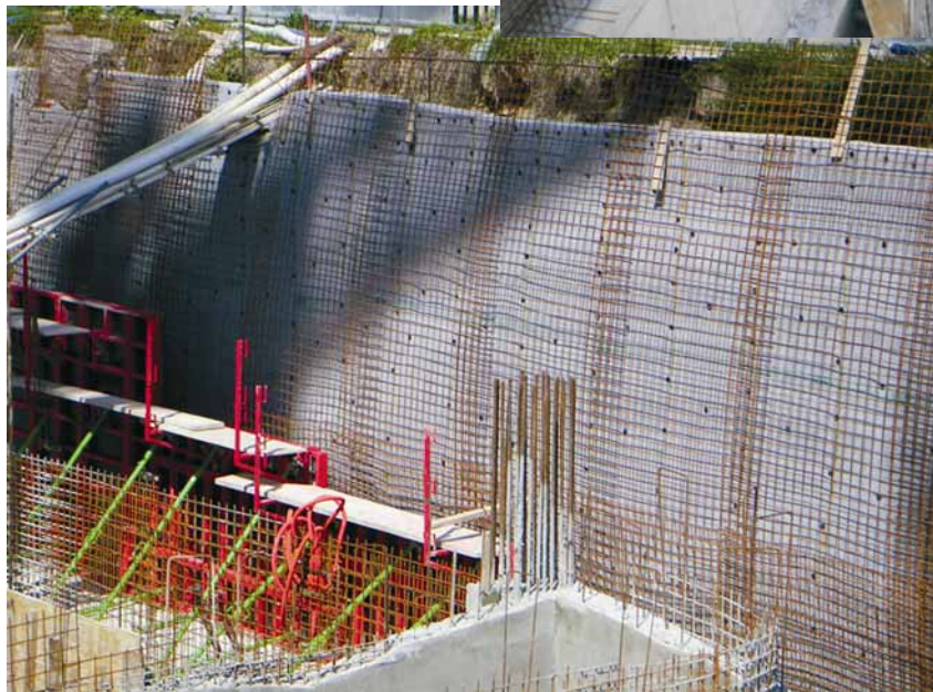
Slika 4. Hidroizolacija podrumskog zida polaganjem Voltexa na torkretiranu podlogu na poslovnoj građevini u Zagrebu
