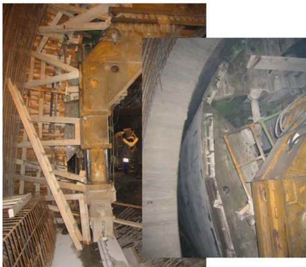
Slika 6. Okomita čelna oplata prije i nakon skidanja
