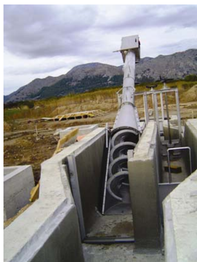
Dio uređaja za pročišćavanje otpadnih voda u Opuzenu
