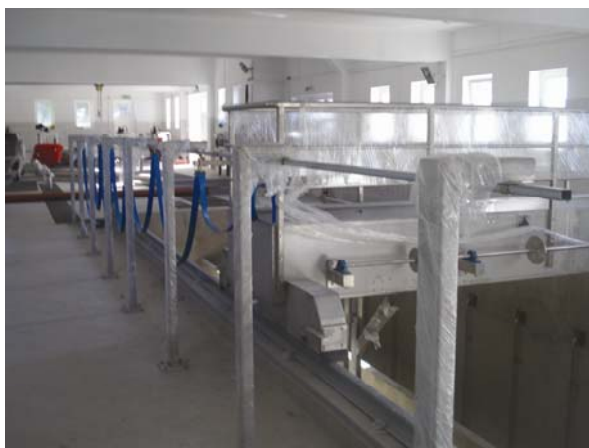
Oprema uređaja za pročišćavanje otpadnih voda u Makarskoj
