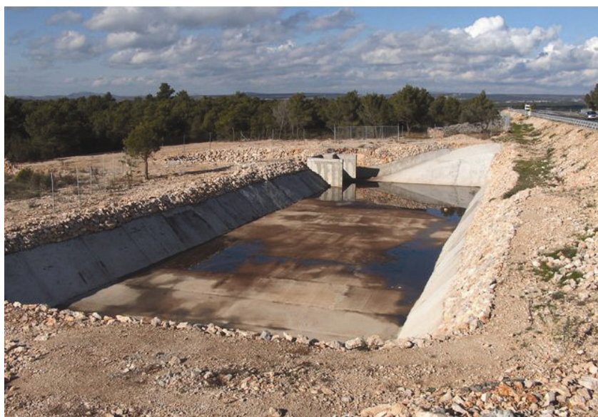
Laguna za pročišćavanje otpadnih voda
