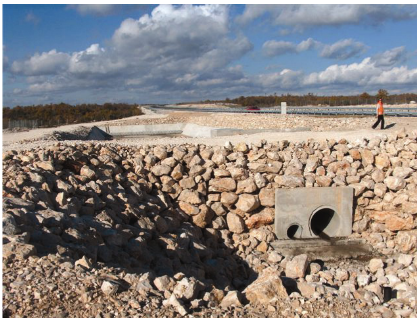
Ispust za pročišćene otpadne vode i oborinske vode
