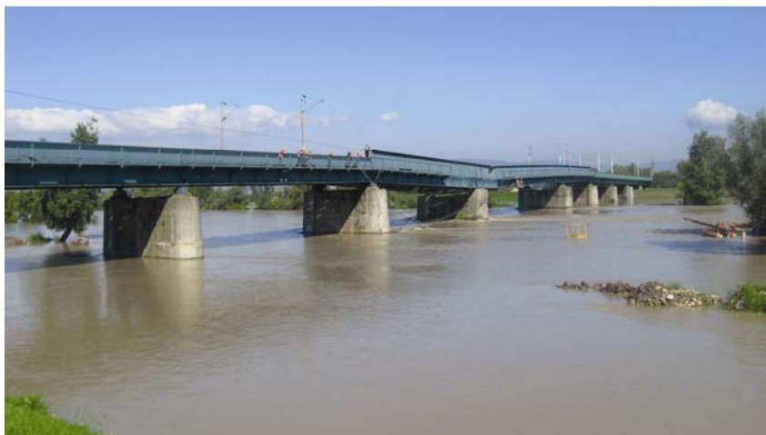
Oštećeni most za najvišega prošlogodišnjega vodostaja
