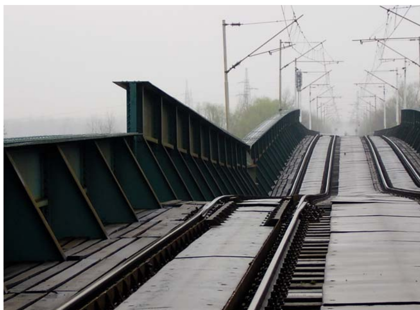
Oštećenja mosta i željezničkih pruga
