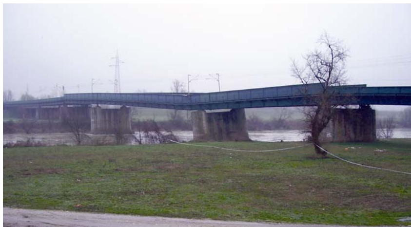
Željeznički most Jakuševac nakon havarije
