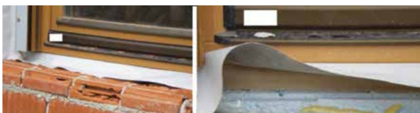
Loša primjena vodonepropusne trake koja nije zalijepljena na podlogu
