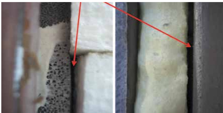
Spoj prozora i zida: loše izveden (lijevo) i pravilno izveden (desno)
