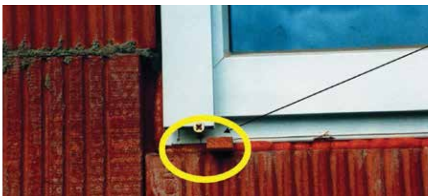
Jedna od češćih pogrešaka - podlošaka ostavljena izvan širine prozora - hladni most
