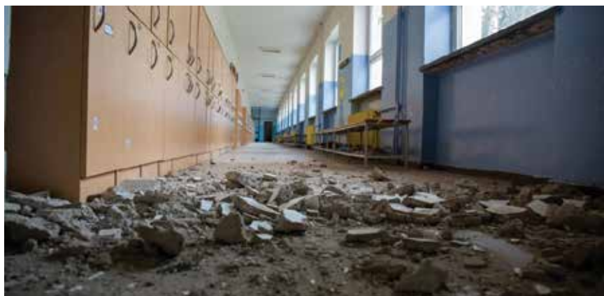
Zagrebačka škola oštećena u potresu (izvor: FaH)
