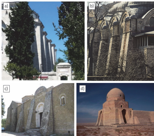
Slika 2. Primjeri trapeznih i trokutnih upornjaka: a) Džamija Süleymaniye (Istanbul, Turska), (fotografija: autori); b) Džamija Piyala Paşa (Istanbul, Turska) [3]; c) Katedrala Sovana (Toskana, Italija) [4]; d) Kongregacijska džamija Eziran (Isfahan, Iran) [5]
