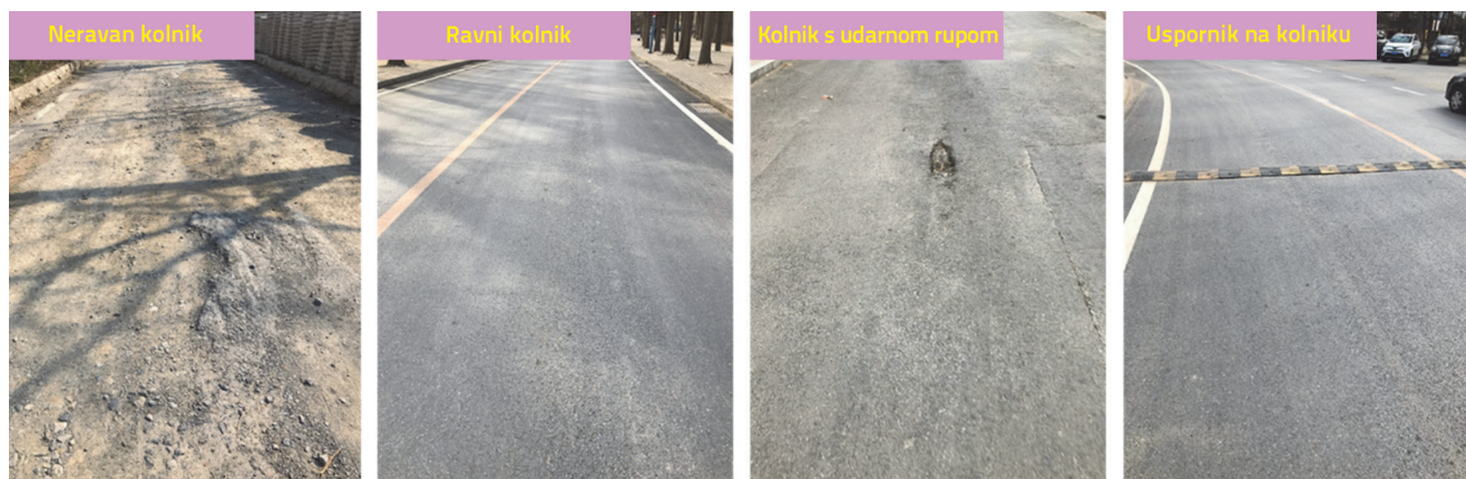
Slika 2. Primjeri neravnog kolnika, ravnog kolnika, kolnika s udarnom rupom i uspornika
