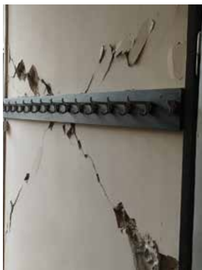
Oštećenja nakon potresa
