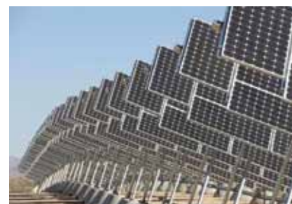
Dva primjera sunčanih elektrana
