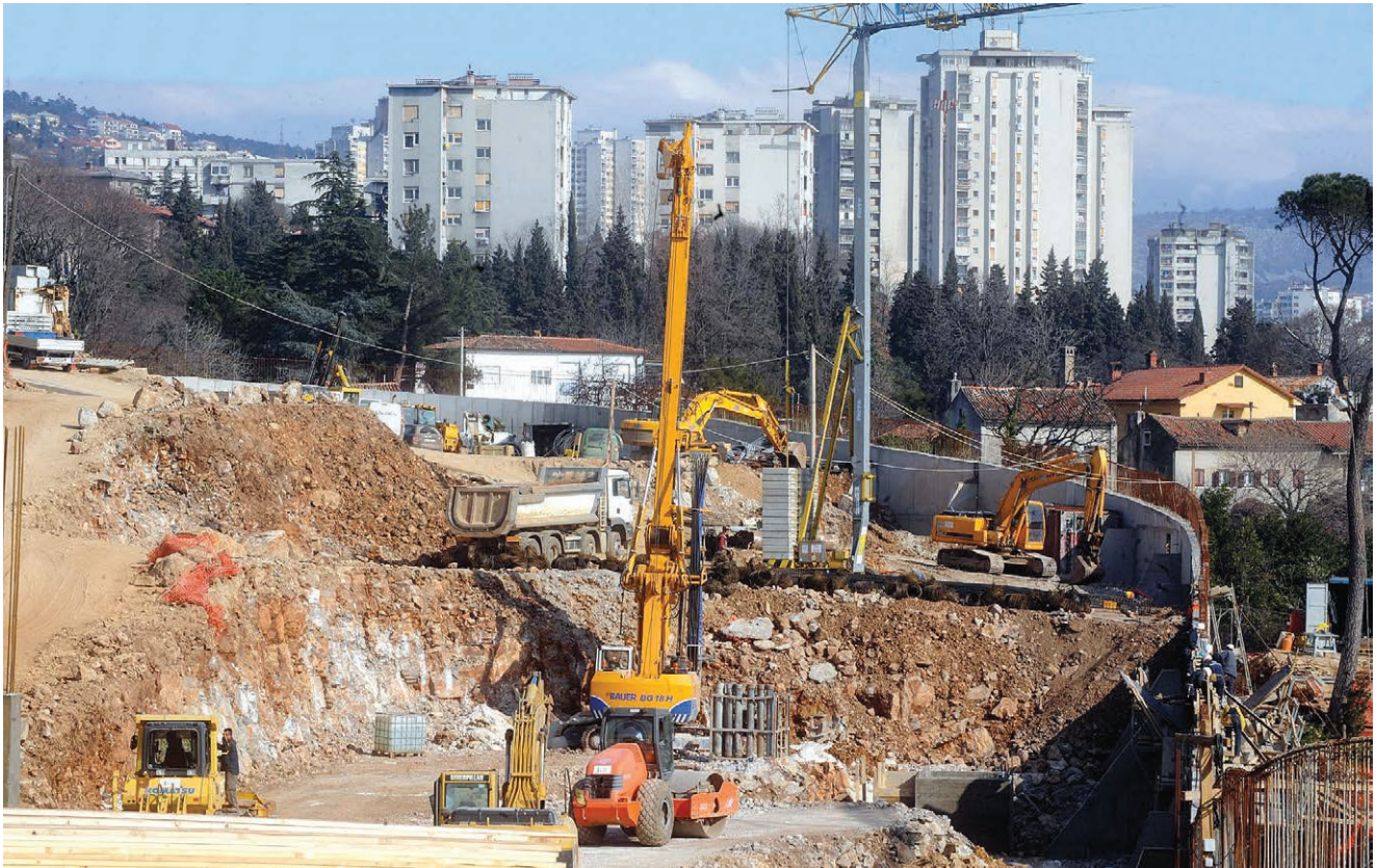
U građevinarstvu postoji loša navika prepisivanja ugovora (detalj s jednog našeg gradilišta)
